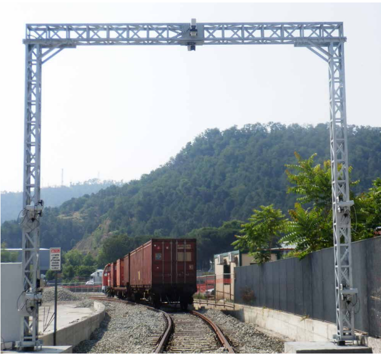
Gate ferroviario automatizzato installato nel porto di Vado Ligure (Progetto CEF Vamp Up)
